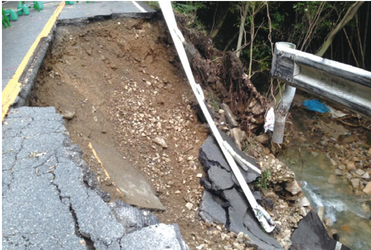
8月豪雨で道路が崩壊した有馬街道（北区）
