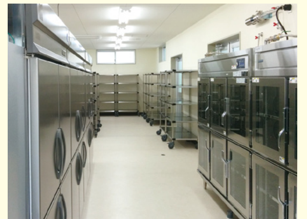
給食配膳設備
