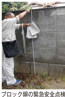
ブロック塀の緊急安全点検
