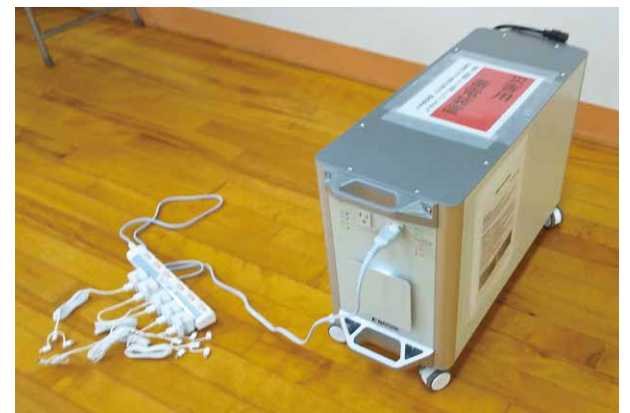
市内の小学校に配備された蓄電池
